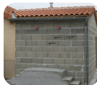
Bouches de remplissage classiques
