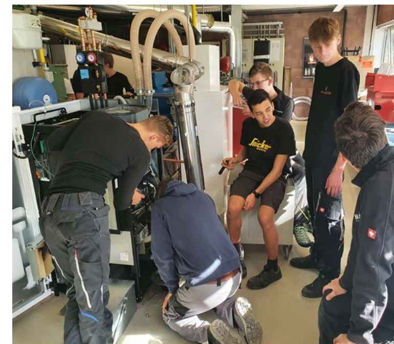
Die Lehrlinge der BS RFK in Absam/Tirol bei der Wartung eines ÖkoFEN Kessels.
