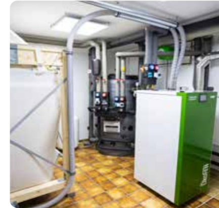
Heizungskeller mit Gewebetank, Systemspeicher und Pelletkessel
