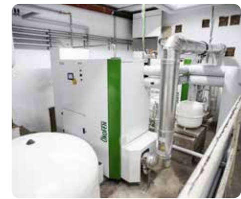
Pellematic Condens XL 2er Kaskade mit je 100 kW Leistung
