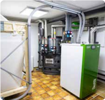
Heizungskeller mit Gewebetank, Systemspeicher und Pelletkessel
